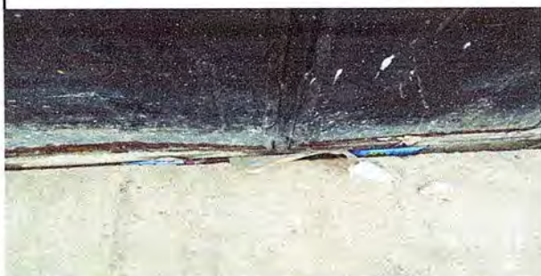
FOTO NO 1. PORTÓN DAÑADA DE ENFREENTE DEL ESTABLECIMIENTO
